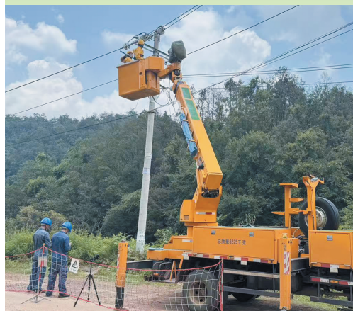
电力运维。周妍蕊 摄
